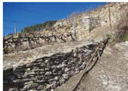
Murs après réfection de mars 2019
