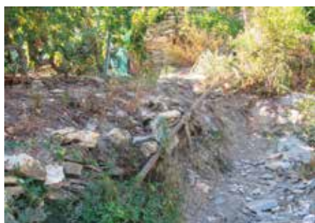
Murs en pierres sèches partiellement effondrés
